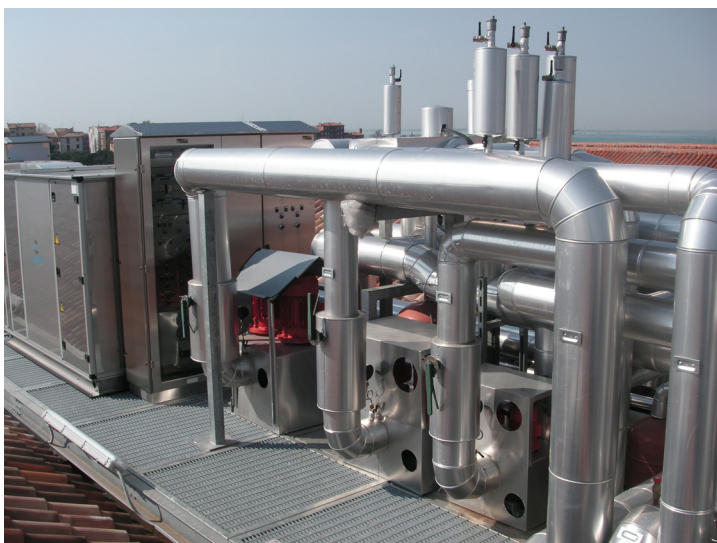
terrazza impianti sulla copertura edificio
