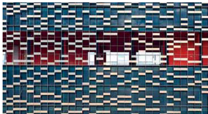
Centro direzionale Fieramilano , Milano, arch. 5+1AA. Sistema di schermatura a pannelli in vetro opacizzato (cortesia di 5+1AA).
