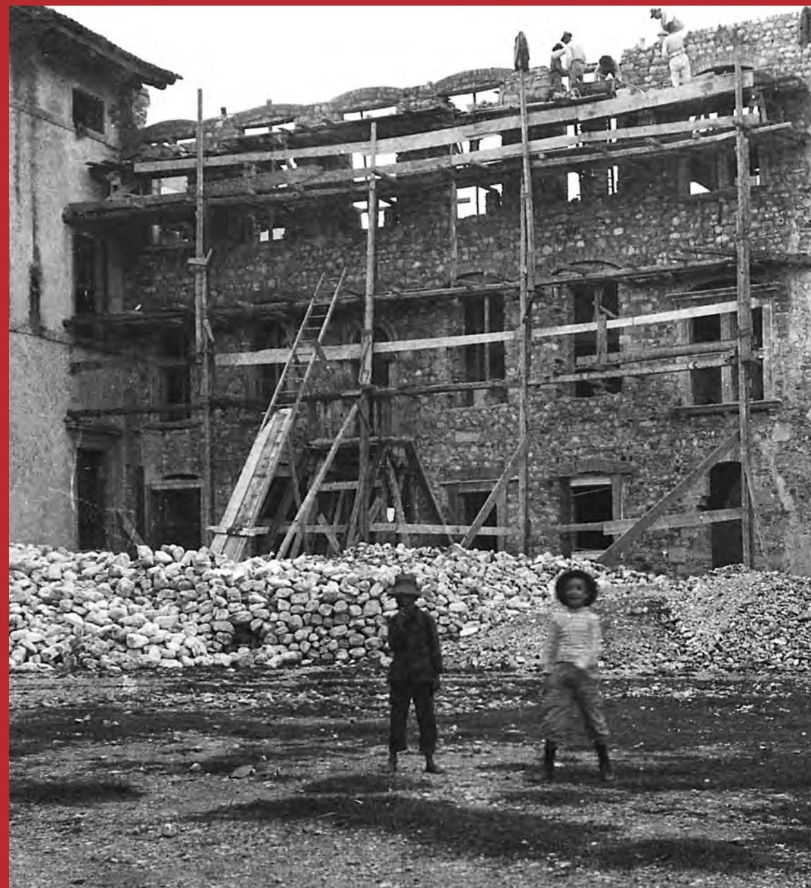
Ricostruzione della facciata interna sulla corte del castello di Spilimbergo (Archivio fotografico SABAP Friuli Venezia Giulia).
